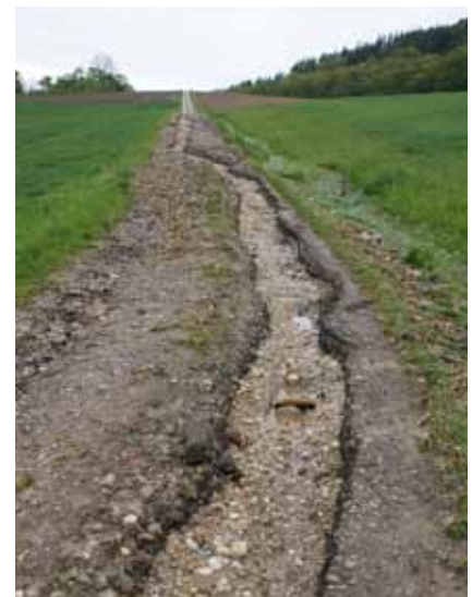
Massive Schäden bei Regenfällen aufgrund von Anschüttungen neben der Straße
