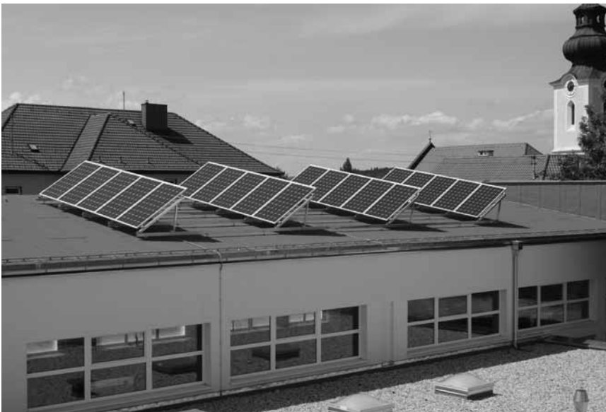
Photovoltaik-Anlage auf der Turnhalle der Hauptschule
